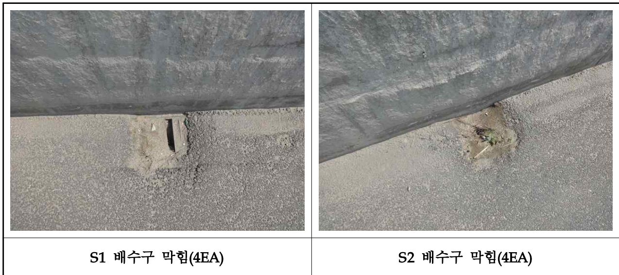
【사진 3.22】 배수시설 손상현황
