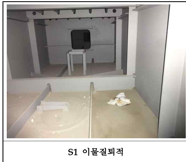
【사진 3.6】 거더 내부 손상현황
